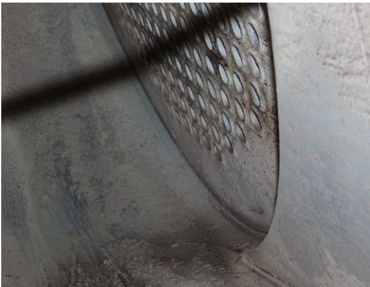
Foto 15 Rauchgas-Austrittskammer aus dem Abhitzekessel mit 2 Eintrittsstutzen der Stoßwelle.
