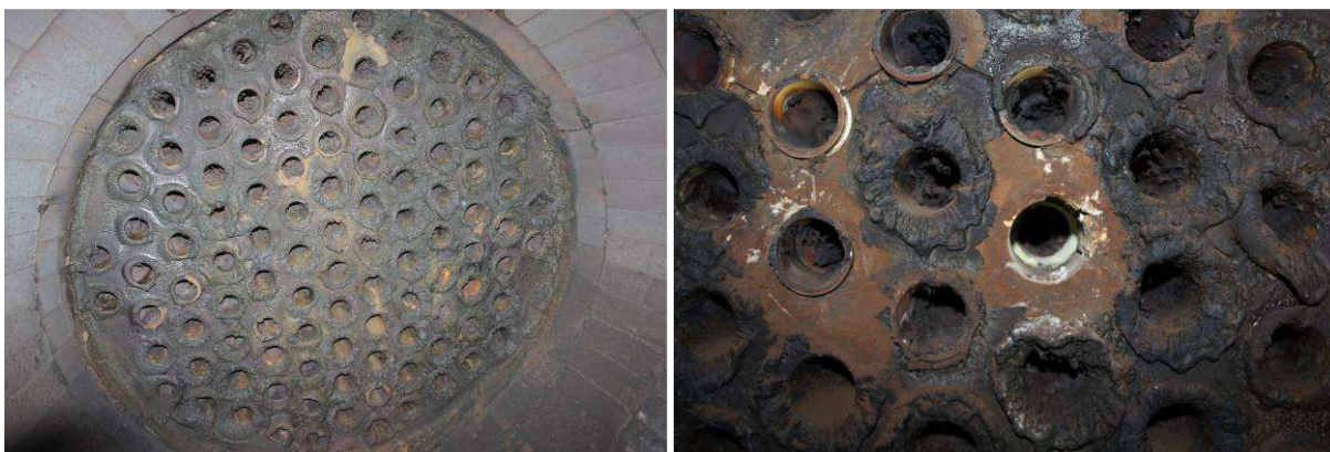
Foto 2 Flammrohre mit Ablagerungen, die den Rauchgasfluss zum 1. Zug begrenzen.
