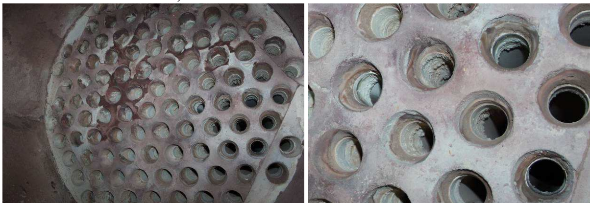
Foto 11 Zusätzlicher Effekt der Reinigung mit Stoßwelle. Austritt-Siebboden des 1. Zuges ohne Ablagerungen, die den Rauchgasdurchfluss behindern könnten.
