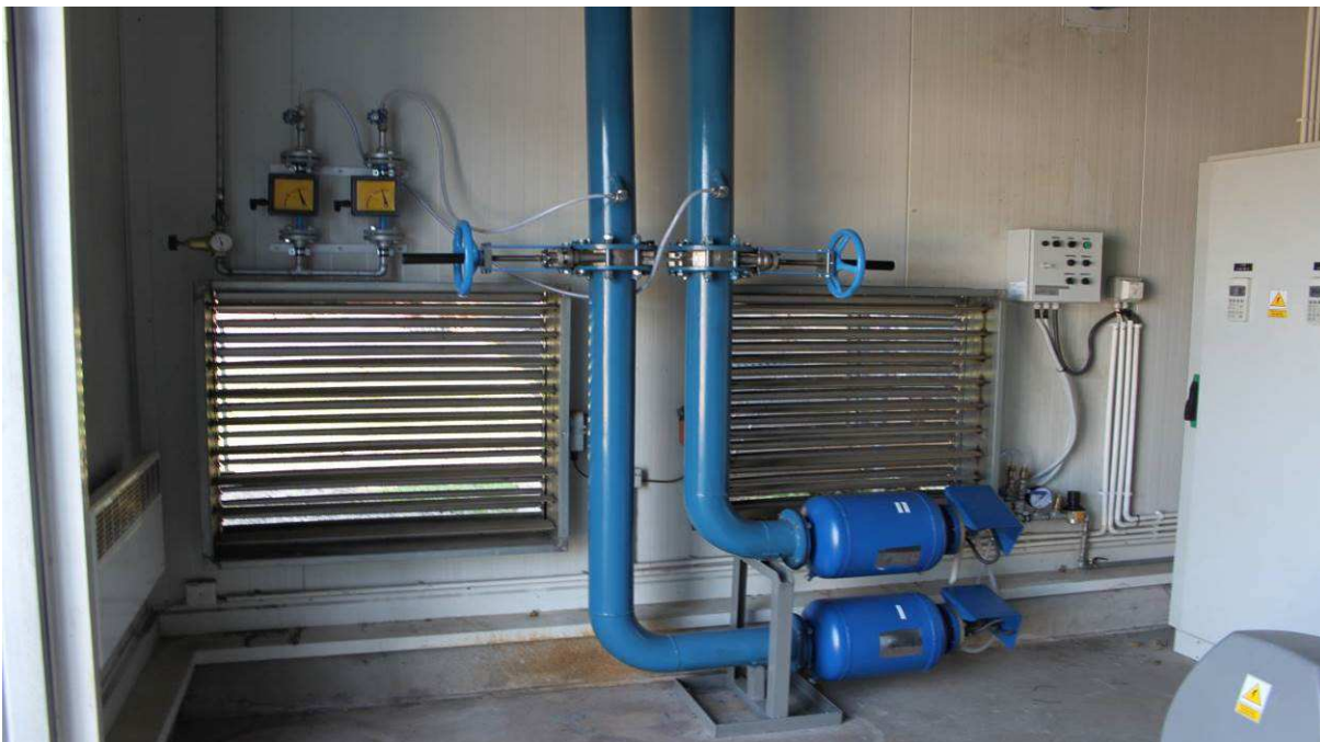
Fot. 7 Dwa generatory fal uderzeniowych GFU-24/8 zabudowane w pomieszczeniu elektrofiltru.
