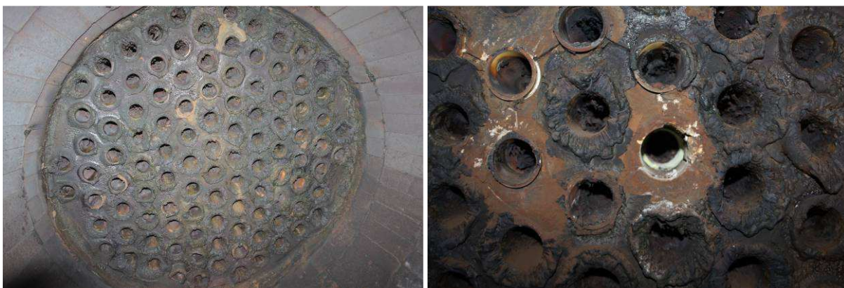
Fot. 2 Płomieniówek z osadami ograniczającymi przepływ spalin do pierwszego biegu kotła.
