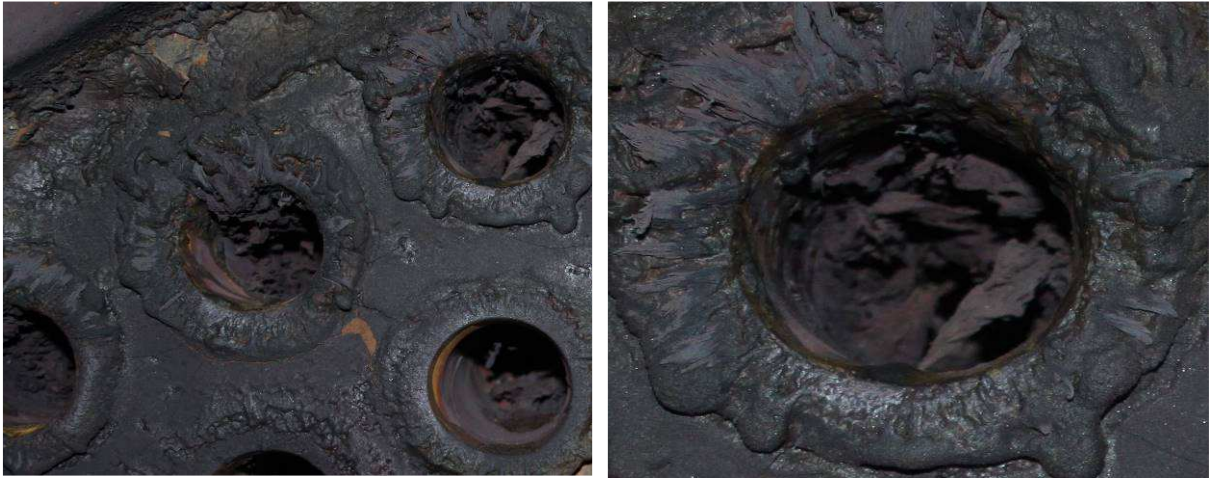
Fot. 3 Zabrudzone płomieniówki w pierwszym biegu kotła odzysknicowego.
