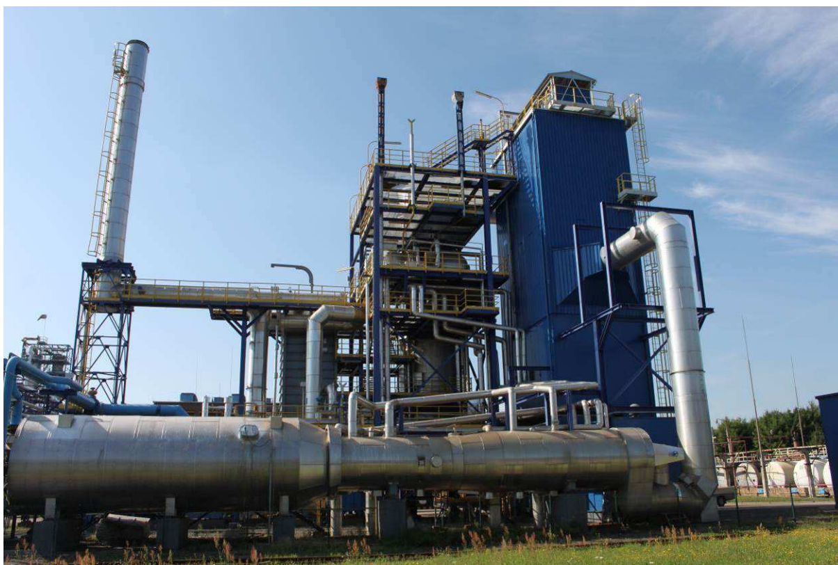
Fot. 1 Instalacja Odzysku Kwasu Siarkowego.
