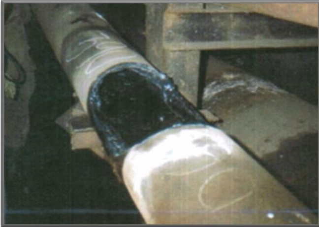
Otwór rewizyjny bezpośrednio za pompą
