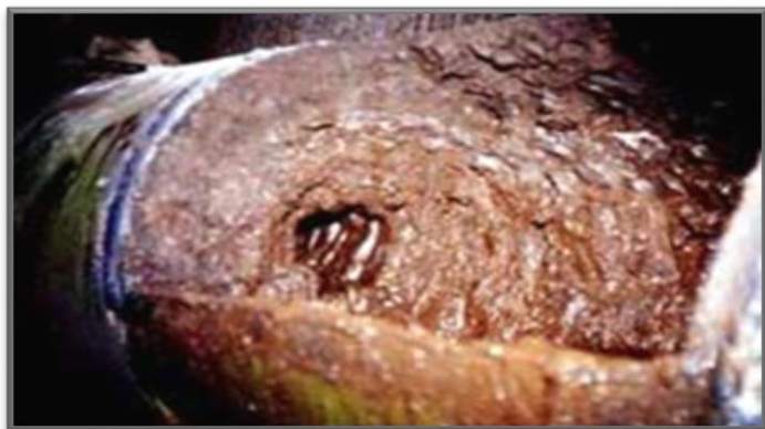
Zanieczyszczona rura w 90 % przekroju.
