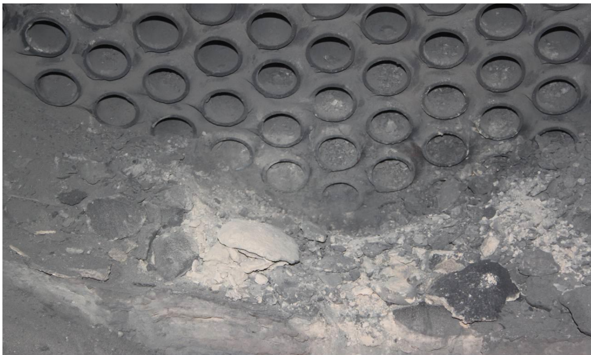
Fot. 13. Zalegające osady w komorze nawrotnej.
