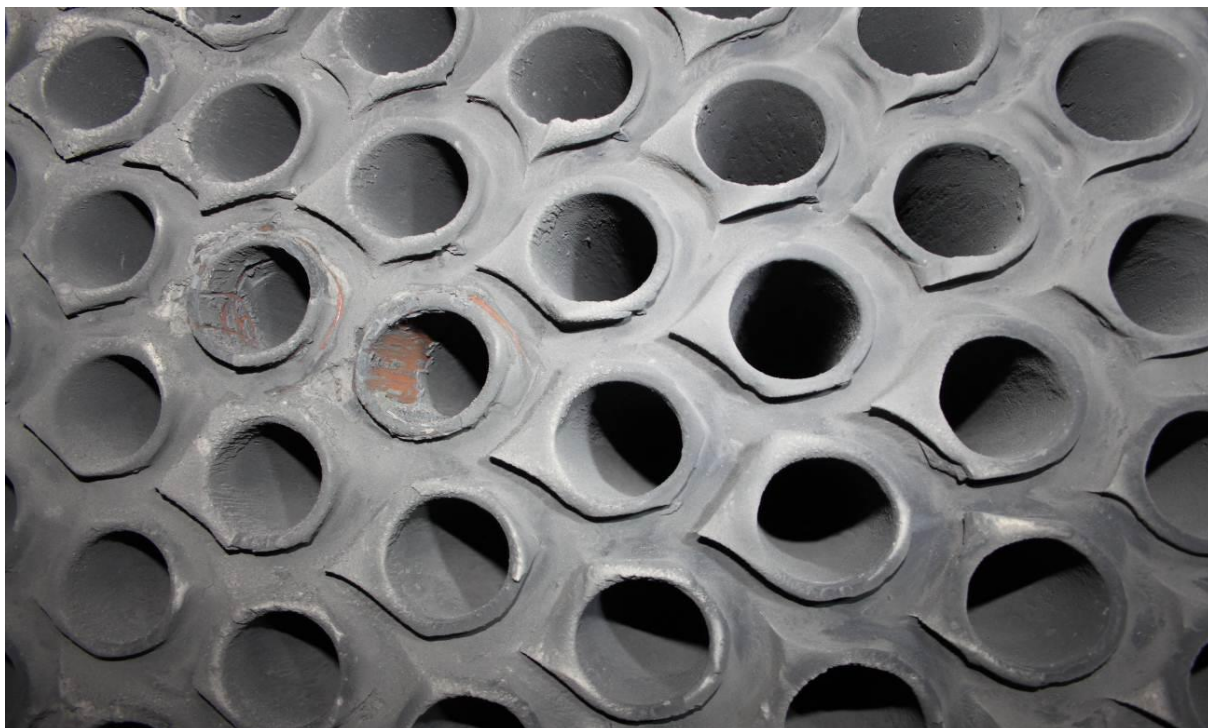
Fot. 11 Cienka warstwa osadów na ściankach płomieniówek.
