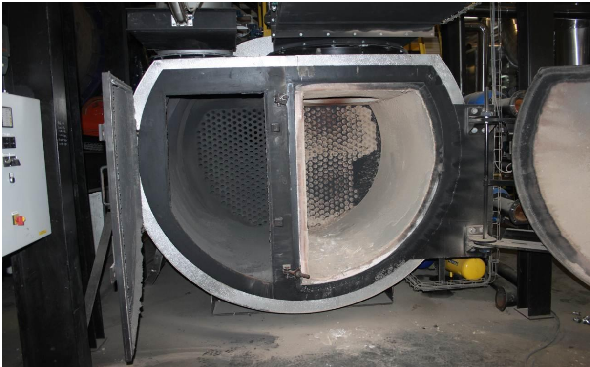
Fot. 15. Komora wylotowa spalin – lewa część wymiennika.
