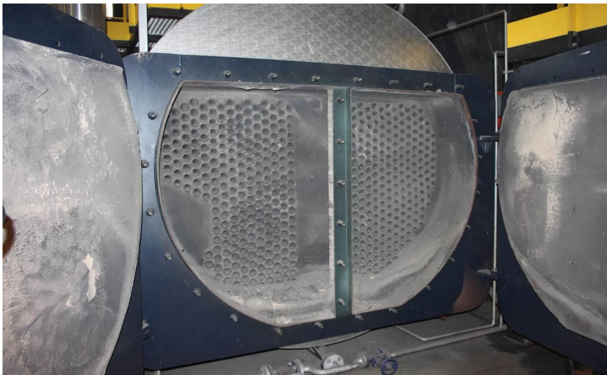
Fot. 14. Zabrudzenie osadami komory nawrotnej.
