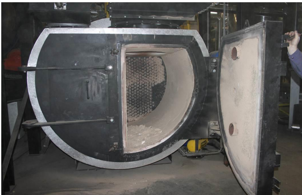
Fot. 7. Wymiennik ciepła na wlocie spalin do płomieniówek.
