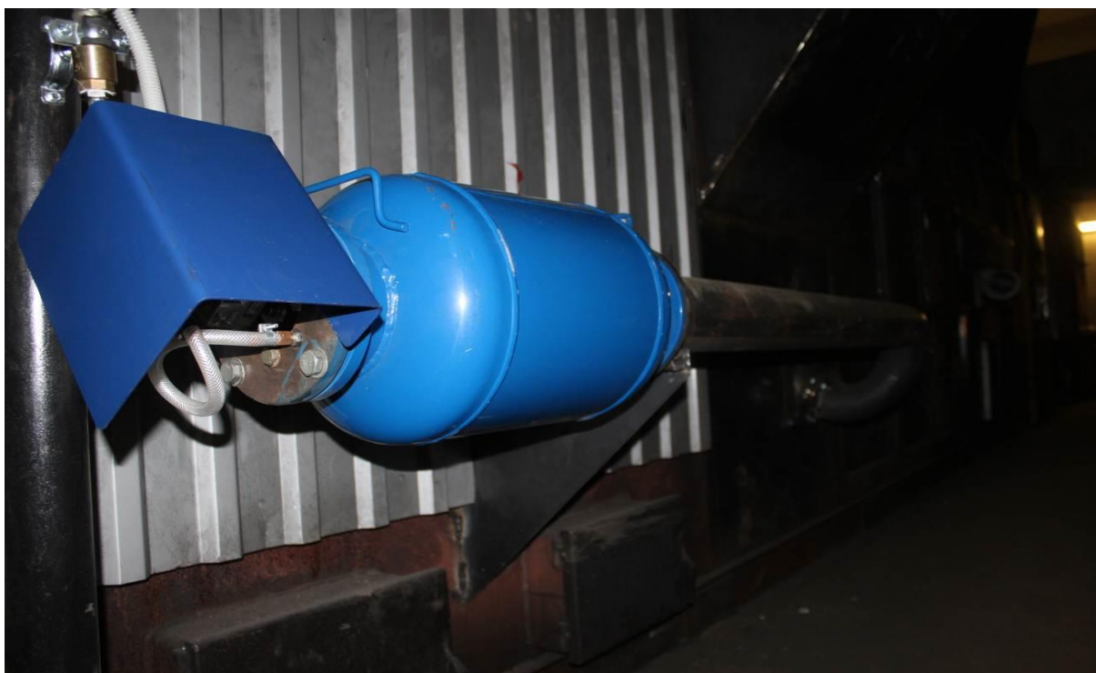
Fot. 20 Generator fal uderzeniowych zabudowany do czyszczenia wymiennika - podgrzewającego powietrze.
