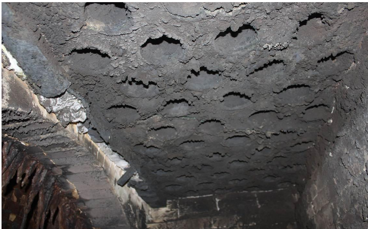
Fot. 19. Wymiennik ciepła od strony spalin bez systemu czyszczenia.
