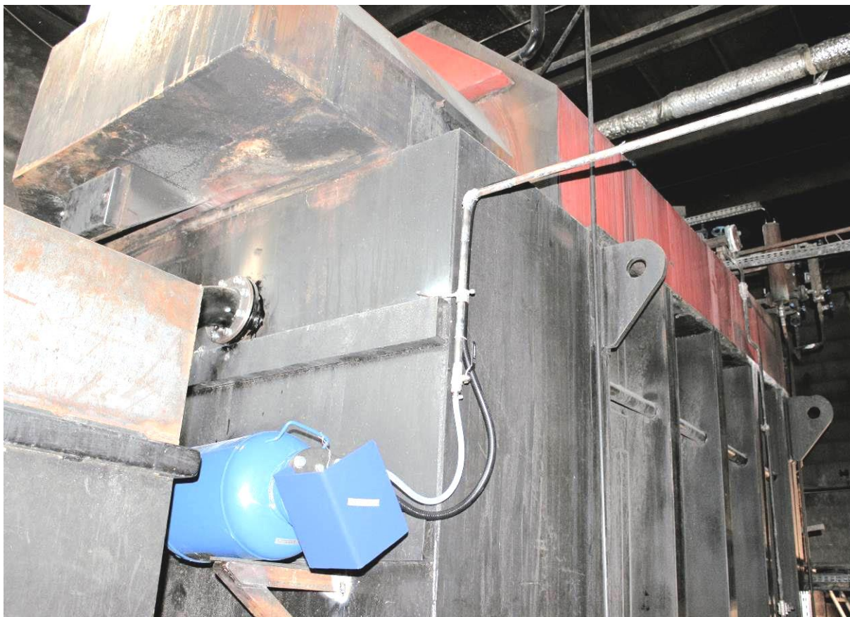
Fot. 17. Kocioł z zabudowanym generatorem GFU-24/8 - YETICO S.A. w Galewiczach koło Wielunia.
