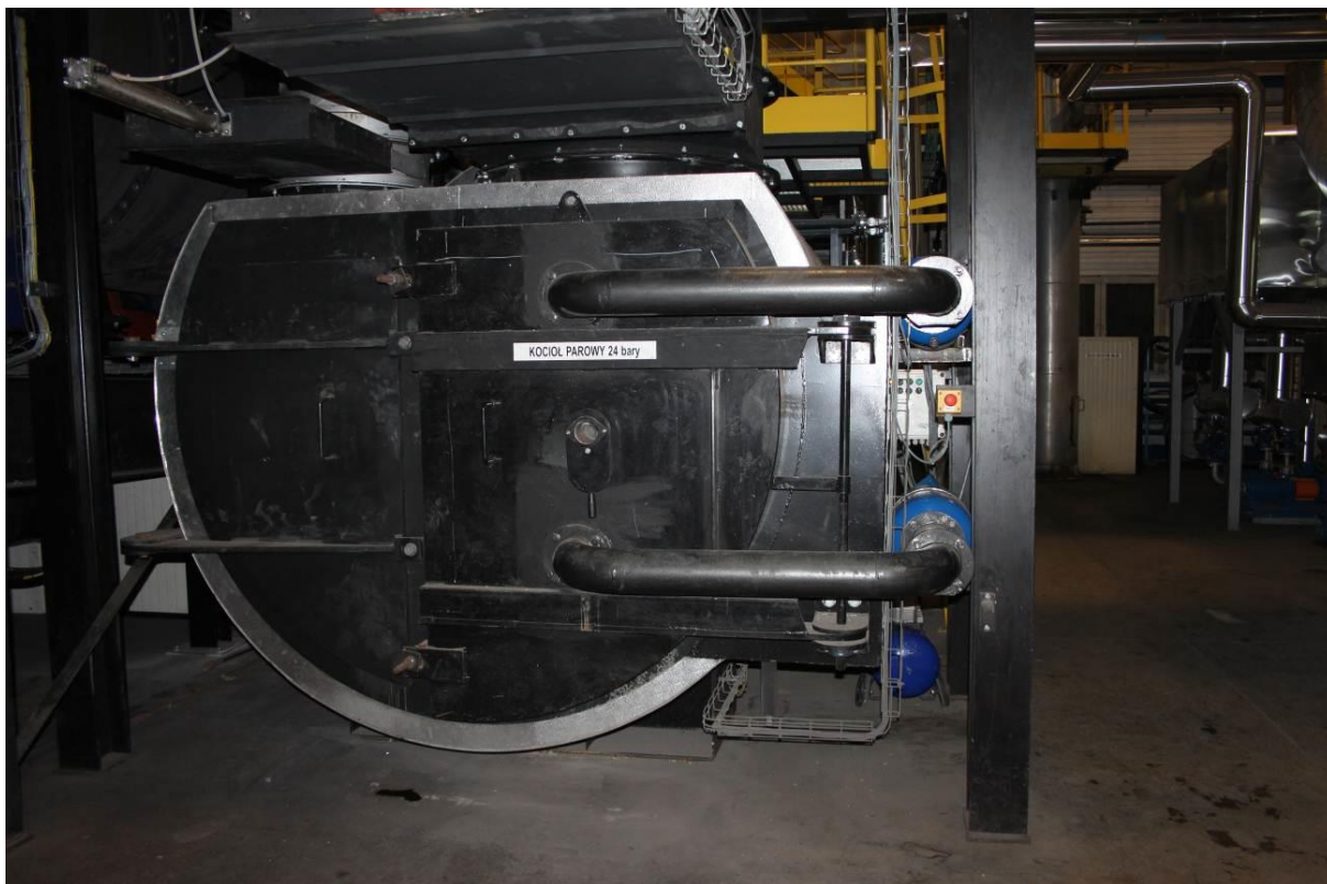
Fot. 3. Wymiennik ciepła z instalacją czyszczenia
