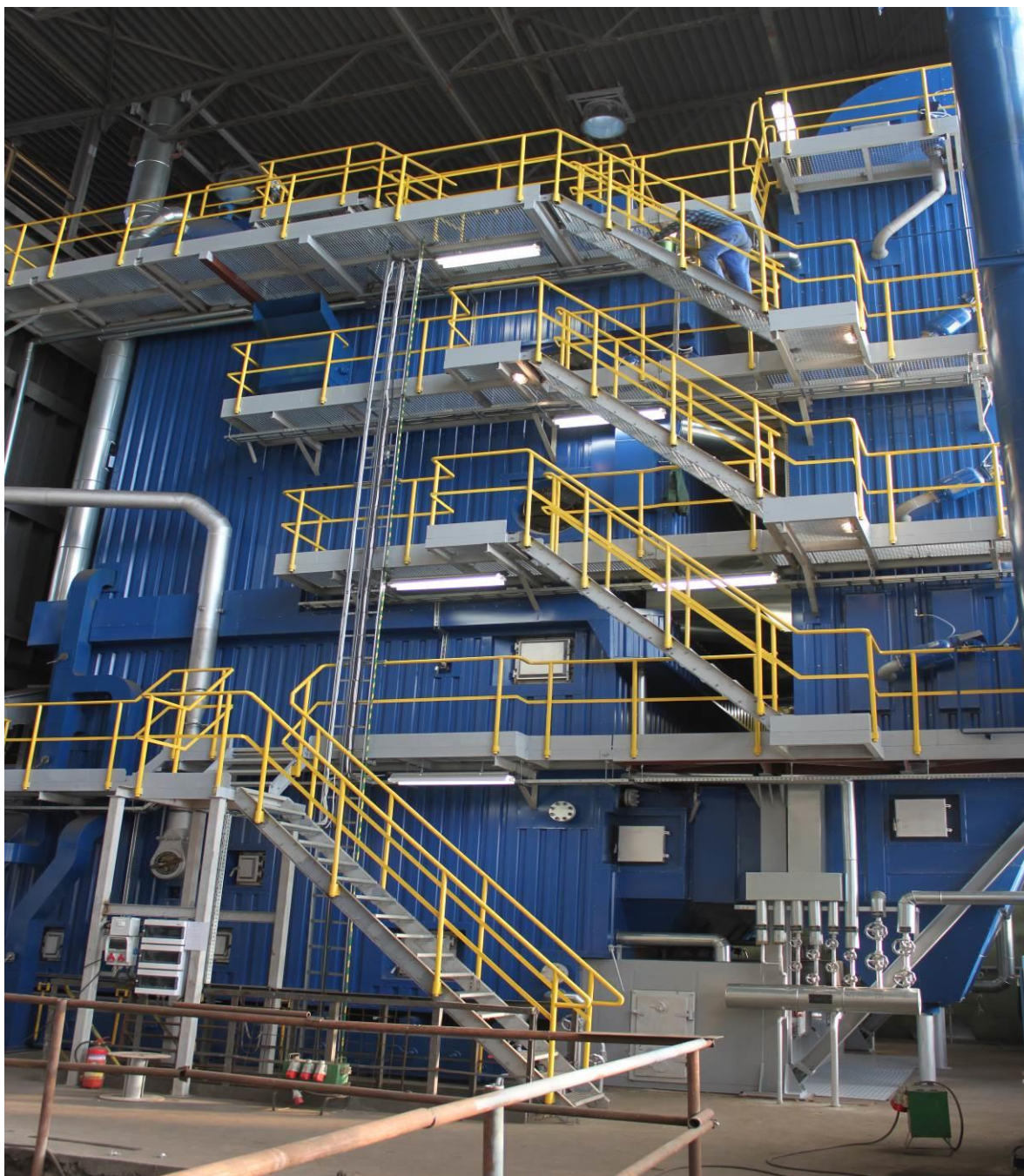
Fot. 1 Kocioł OR-32 z generatorami fal uderzeniowych w trzecim ciągu.
