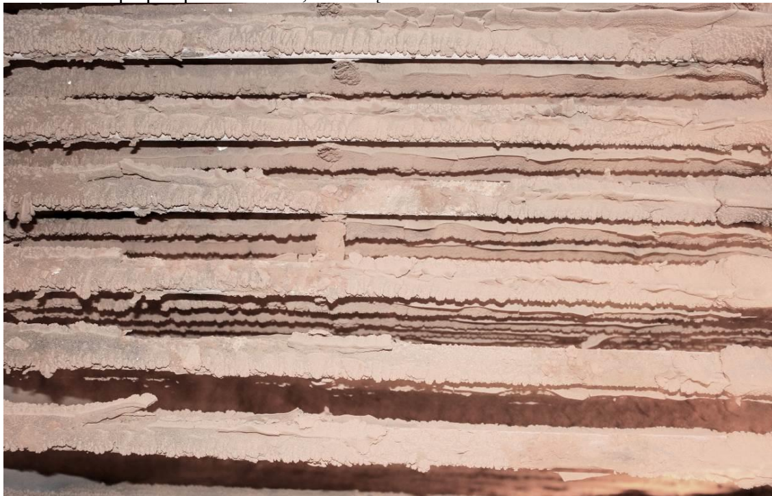
Fot. 11 Rury przegrzewacza pary kotła OR-50 po 1,5 miesięcznej eksploatacji.
