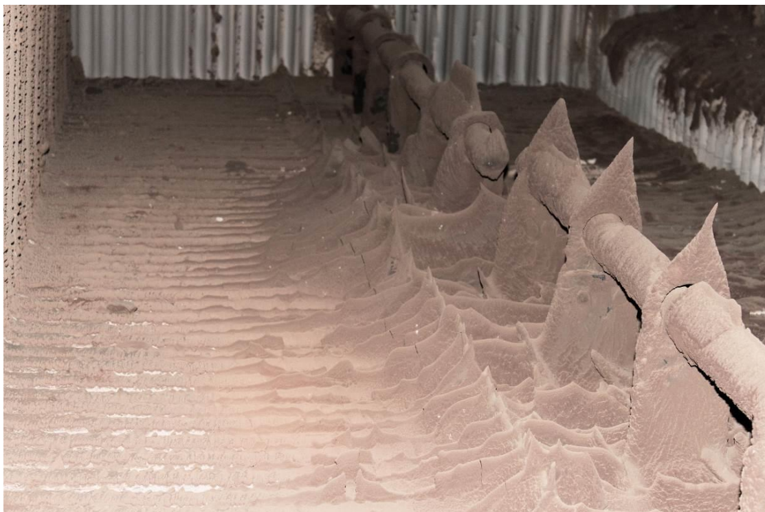
Fot. 9 Zabrudzenie rur przegrzewacza pary kotła OR-50 po przepracowaniu 1,5 miesiąca.
