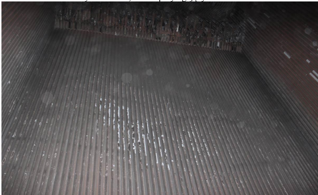
Fot. 1 Komora paleniskowa kotła OR-32 – ściana tylna
