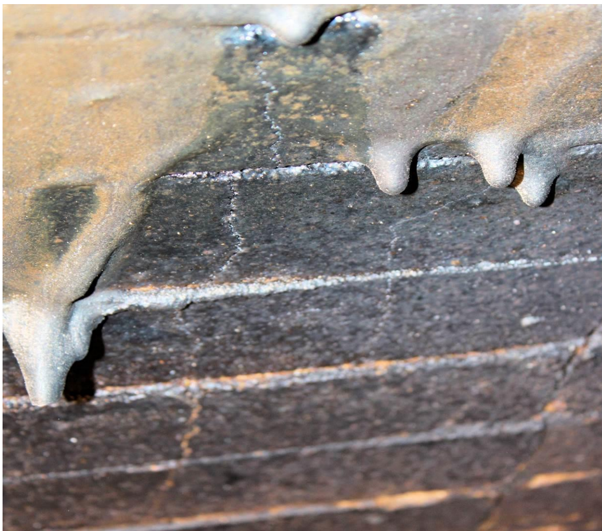
Fot. 5 Pęknięcia kształtek sklepienia zapłonowego.
