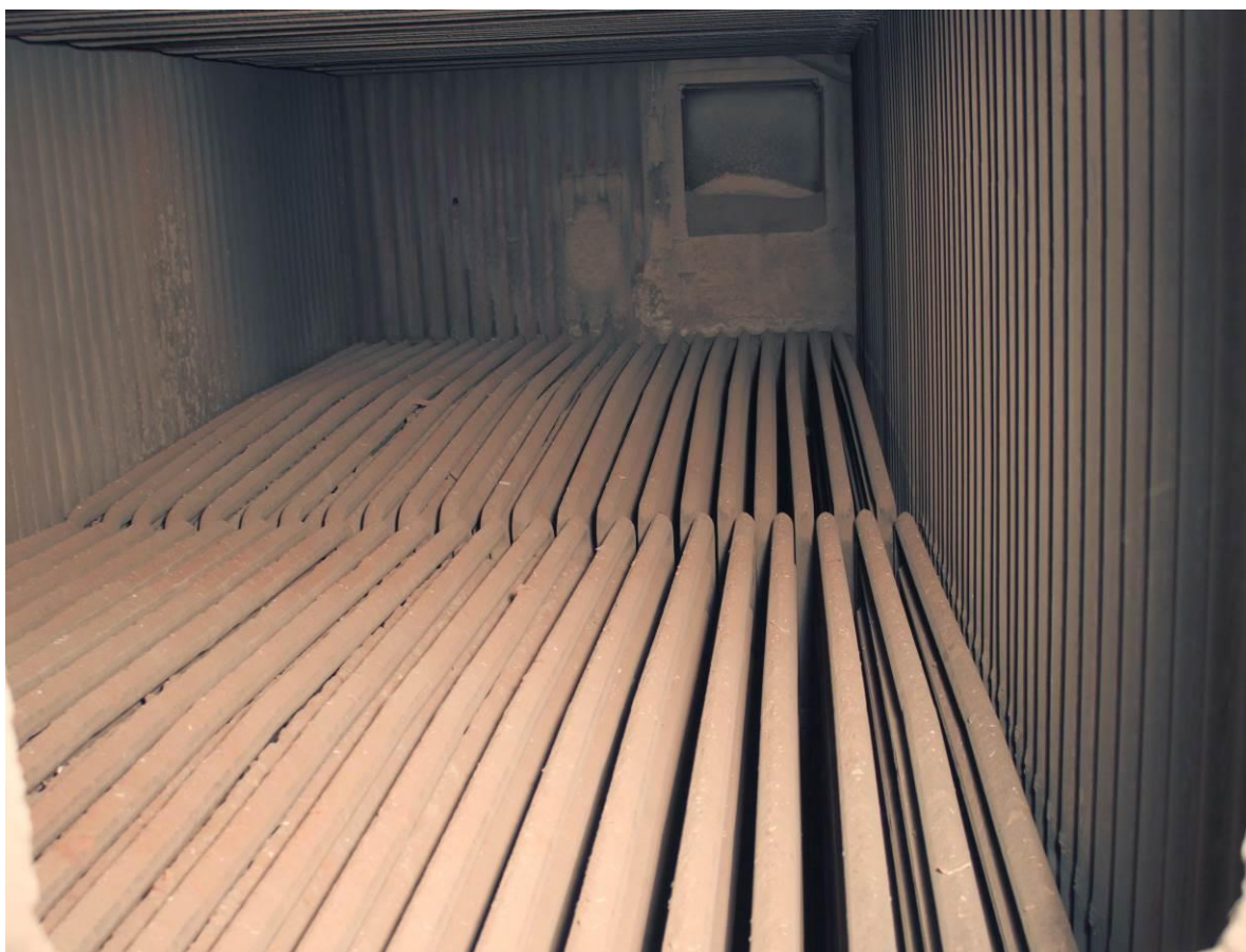
Fot. 15 Parownik kotła OR-32 zabudowany za przegrzewaczem pary.
