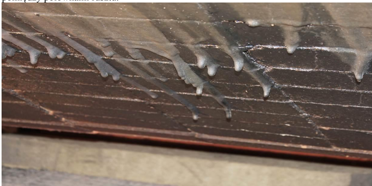
Fot. 4 Nadtopienia sklepienia w strefie środkowej.
