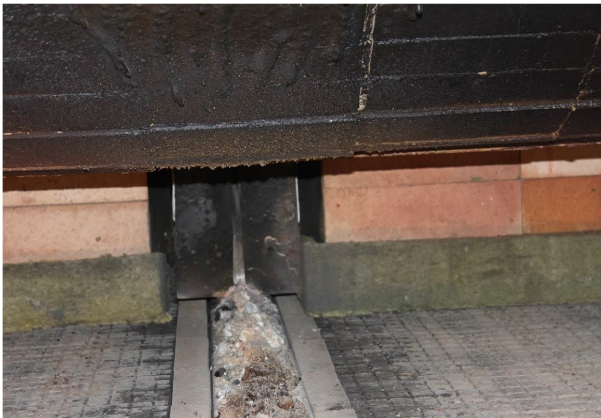
Fot. 6 Obszar nieszczelności pomiędzy lewą i prawą stroną warstwowicy.
