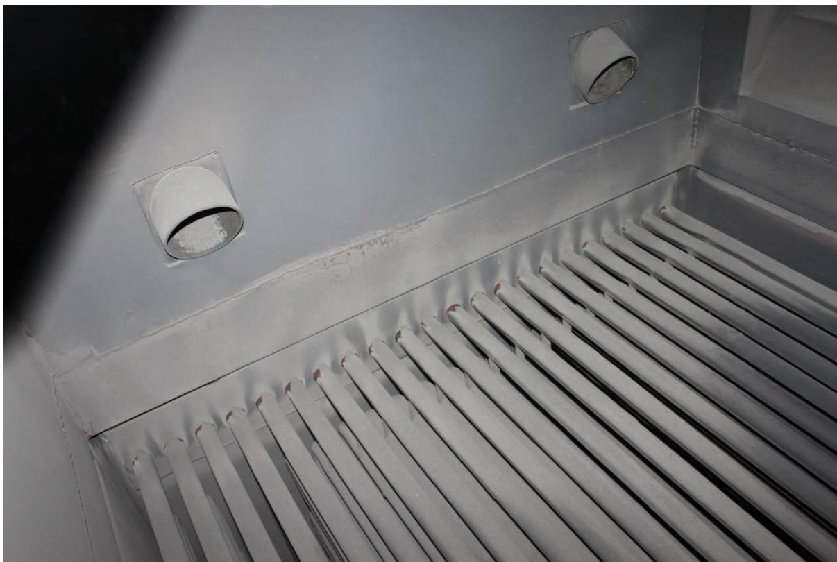
Fot. 8 Wyloty fali uderzeniowej wraz z rurami pęczka podgrzewacza wody.
