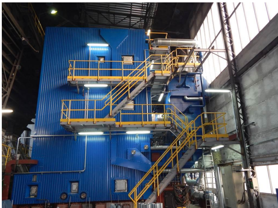
Fot. 1 Kocioł WR-25 nr 1 w technologii ścian szczelnych.
