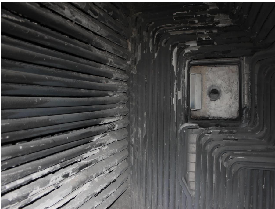
Fot. 5 Rury festonu kotła z niewielką ilością osadów.
