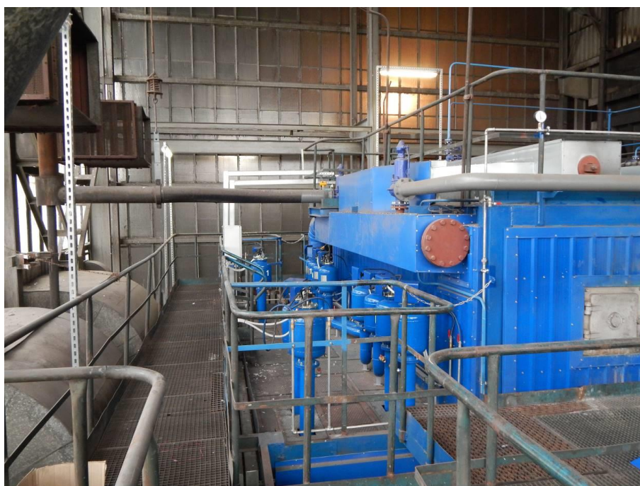
Fot. 1 Generatory fal uderzeniowych GFU-24/8 zabudowane w kotle WR-25 na obmurzu ciężkim w Ciepłowni Bielszowice w Rudzie Śląskiej.
