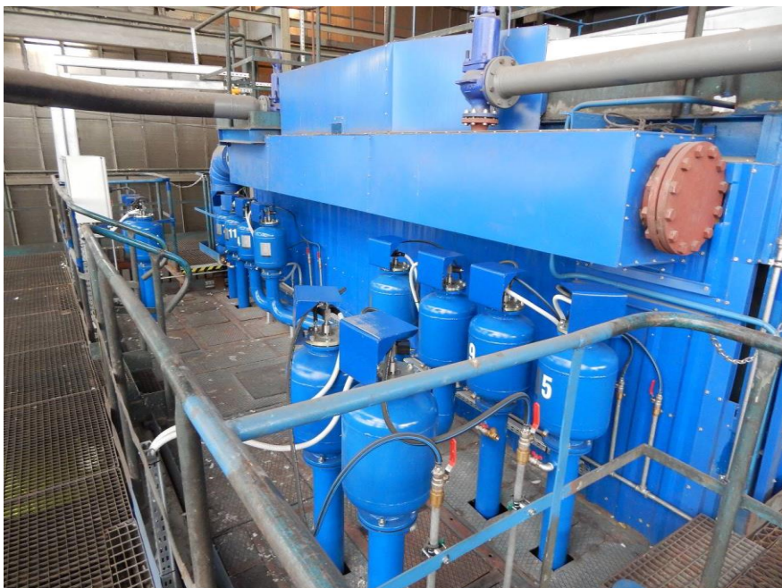
Fot. 2 Lokalizacja generatorów fal uderzeniowych na kotle WR-25 na obmurzu ciężkim.
