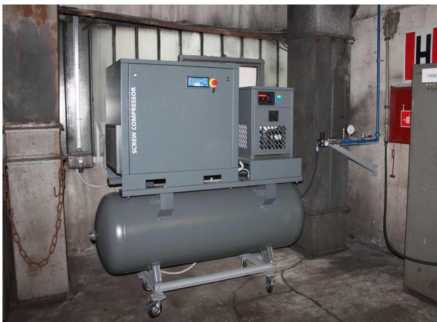
Fot. 3 Sprężarka śrubowa do zasilania instalacji oczyszczania powierzchni grzewczych kotła WR-25.
