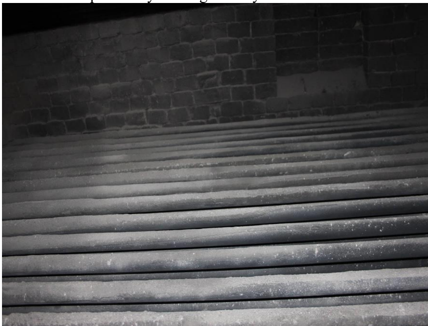
Fot. 7. Rury pęczka podgrzewacza wody w drugim ciągu.
