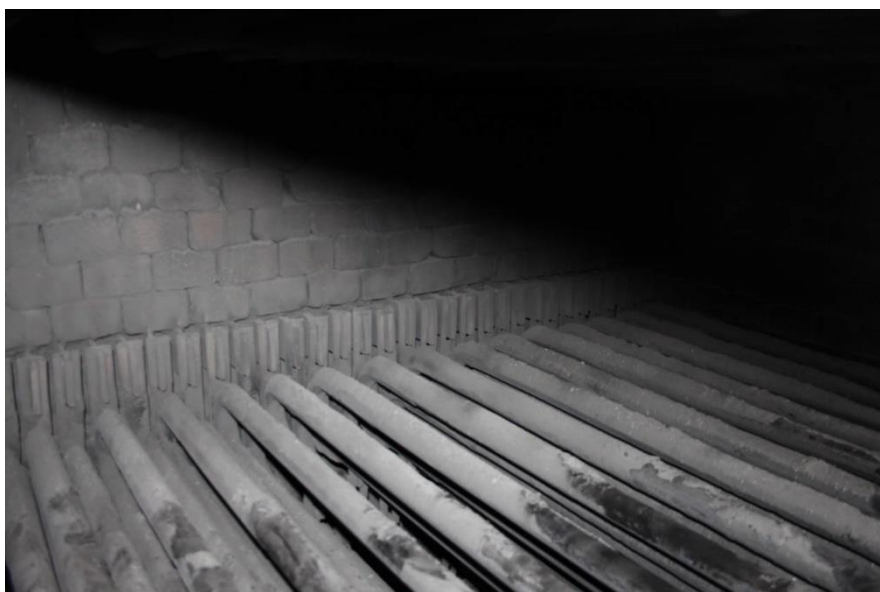
Fot. 8 Rury pęczka podgrzewacza wody w trzecim ciągu.
