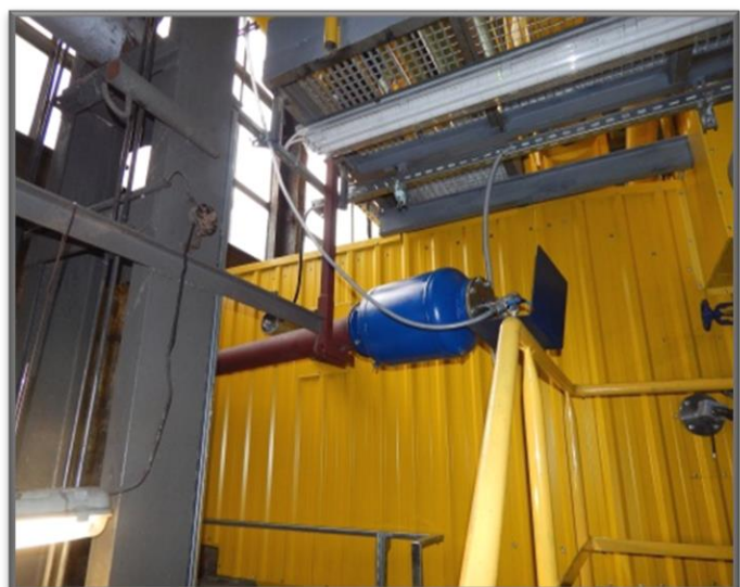
Installation of cleaning boiler economizer WR-10 in Nadwiślańska Spółka Energetyczna - Heating Plant in Bieruń
