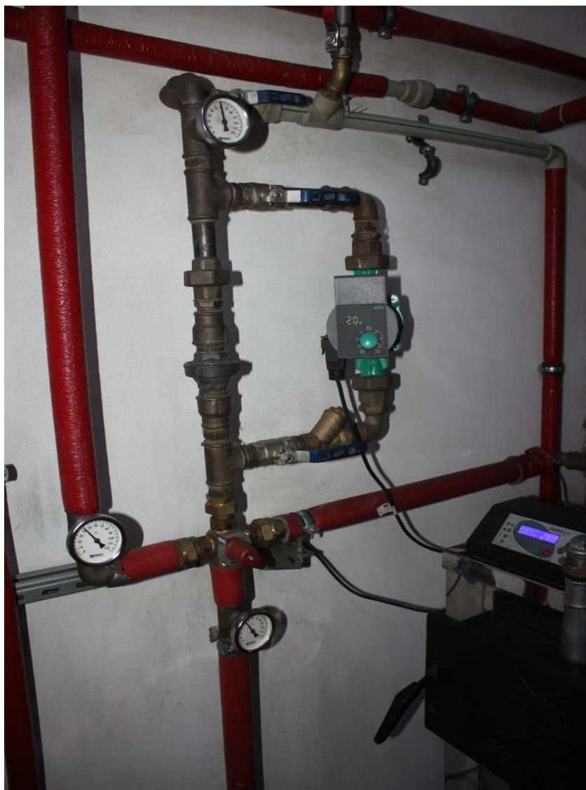
Fot. 4 Najprostszy układ mieszający oparty o ręczny zawór czterodrogowy zapewniający temperaturę wlotową do kotła na poziomie 45 °C.
