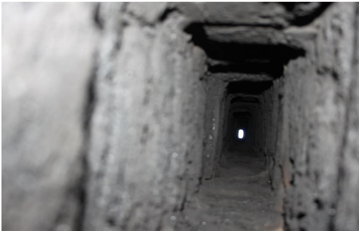
Fot. 1 Przewód kominowy z widoczną warstwą osadów, które się zestaliły do twardej skorupy.
