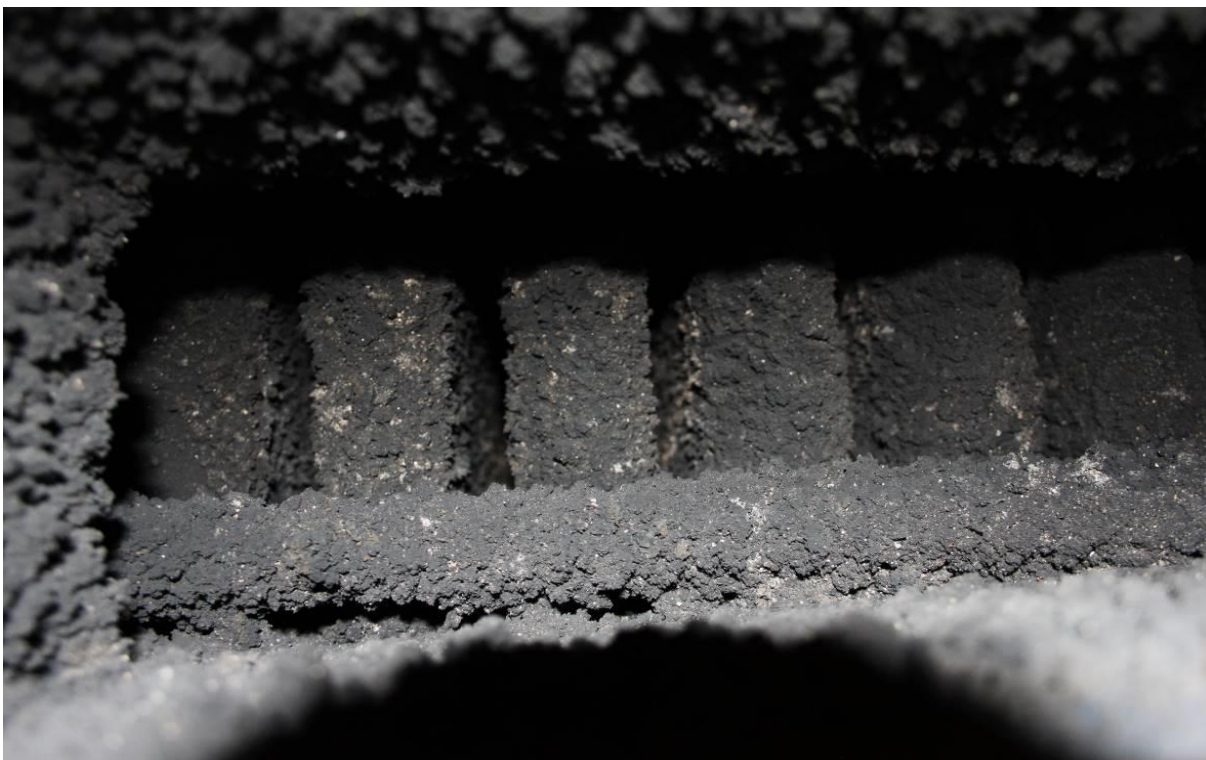
Fot. 8 Powierzchnie wewnętrzne kotła po tygodniu od ręcznego czyszczenia.
