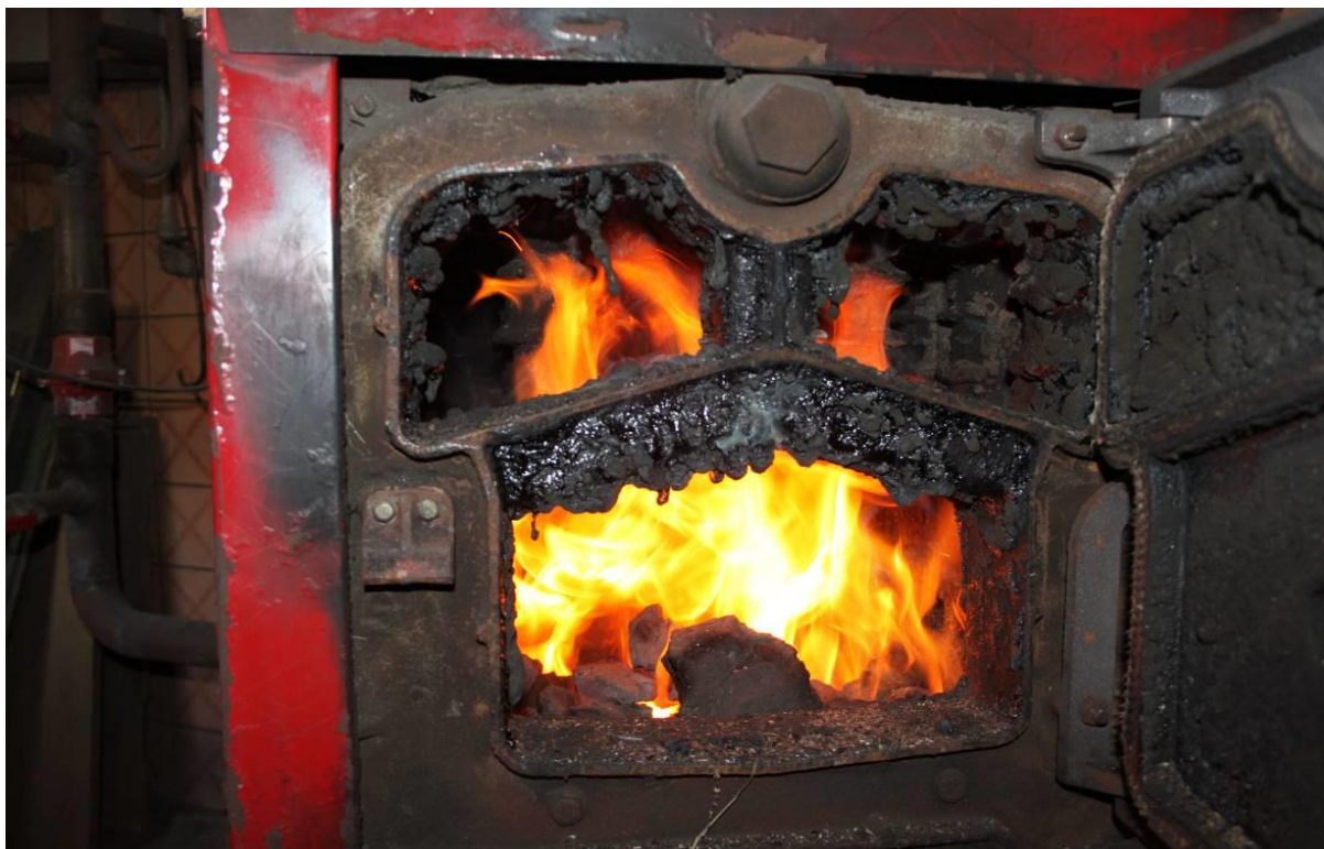
Fot. 5 Duże ilości smoły w komorze paleniskowej powstałej w wyniku zbyt niskich temperatur wody wlotowej i wylotowej z kotła oraz nieodpowiedniej ilości powietrza do spalania.
