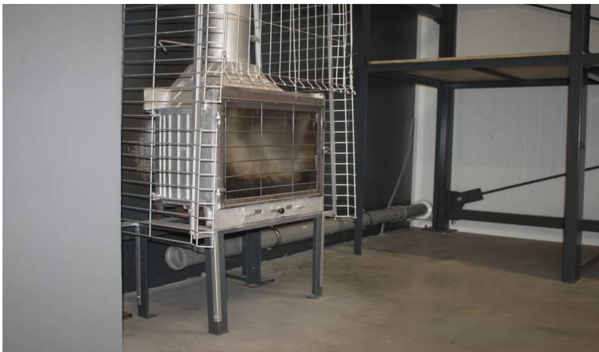
Fot. 2 Doprowadzenie powietrza rurą PCV z zewnątrz do kominka ogrzewającego halę przemysłową.
