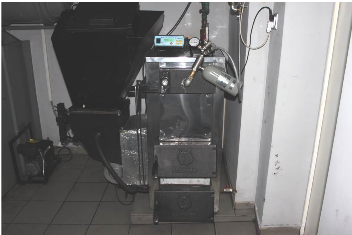
Fot. 4. Generator fali uderzeniowych GFU-1/15 zabudowany na kotle o mocy 24 kW.
