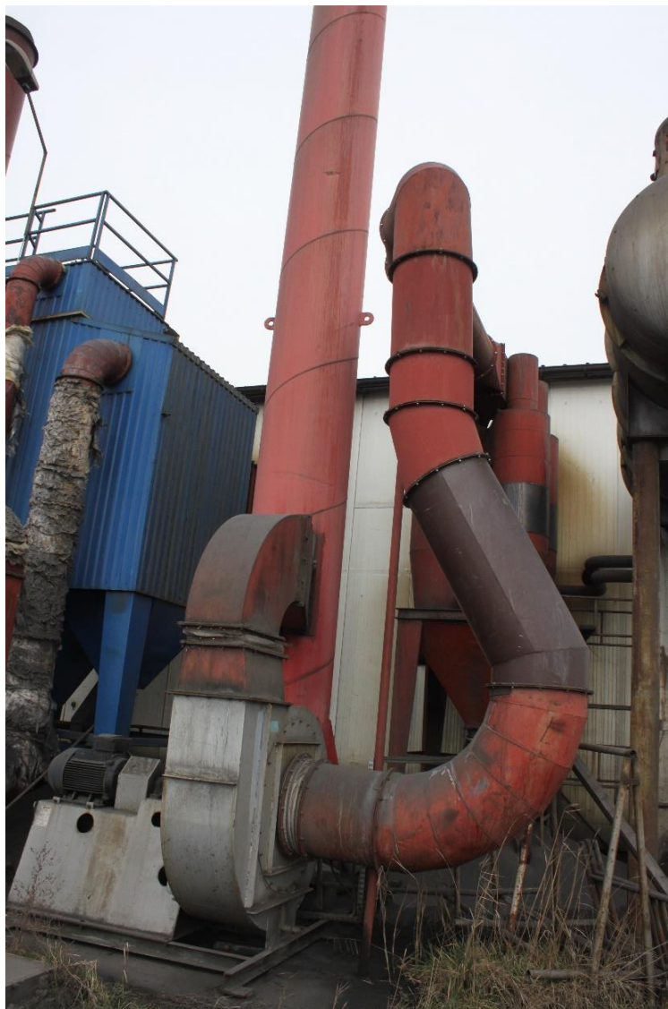
Fot. 2 Niezaizolowane kanały spalinowe wraz z wentylator wyciągowy spalin.
