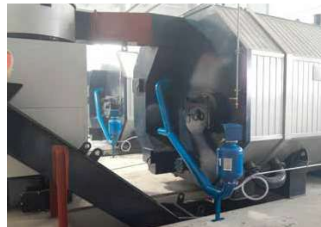
System czyszczenia dwóch kotłów płomieniówkowych o mocy 3 MW FOTOGRAFIE A. ZUBER
