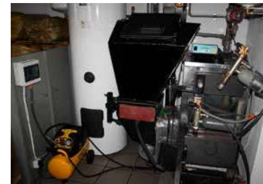
Generator fal uderzeniowych GFU-1/15 zabudowany na kotle o mocy 24 kW
