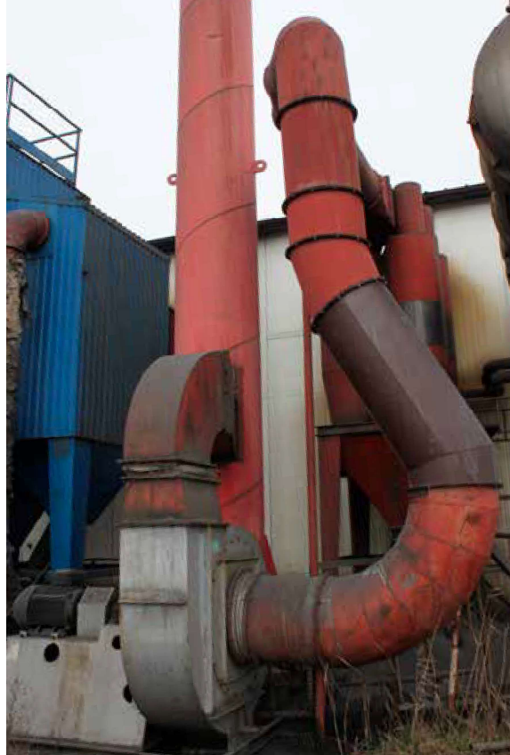
Nieizolowane kanały spalinowe wraz z wentylatorem wyciągowym spalin
