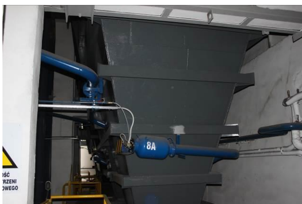
Fot. 6 Zasobnik węgla w PEC Gliwice z zabudowanymi generatorami.
