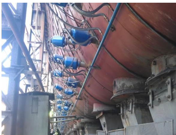
Fot. 4 Zasobnik rudy żelaza z zabudowanymi generatorami GFU-24/8.
