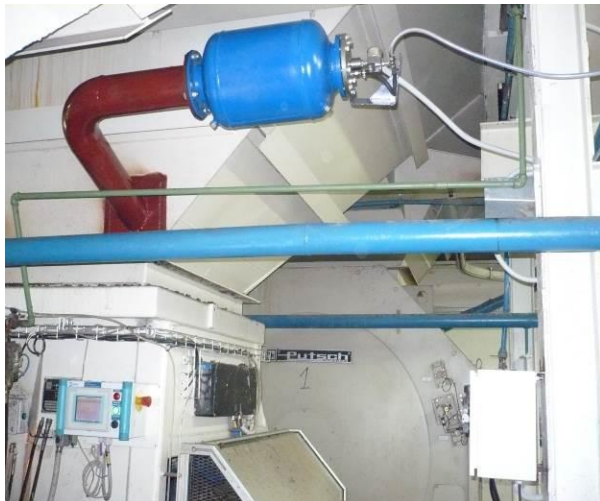
Fot. 12 Generator fal uderzeniowych GFU-24/8 zabudowany na zbiorniku buraków.
