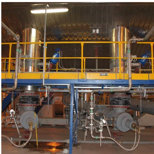
Fot. 17. Schładzacz popiołu wraz zabudowanymi generatorami GFU-24/8.
