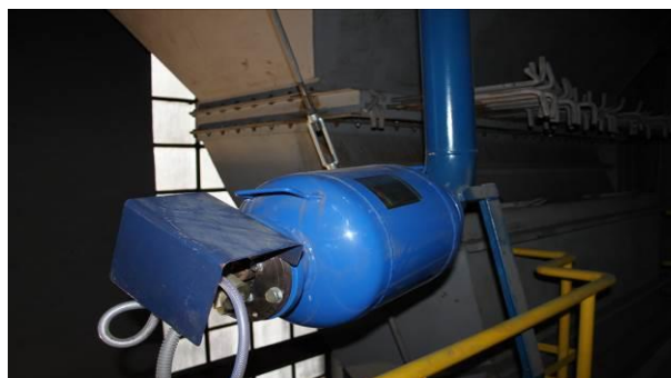
Fot. 9 Generator fal uderzeniowych
