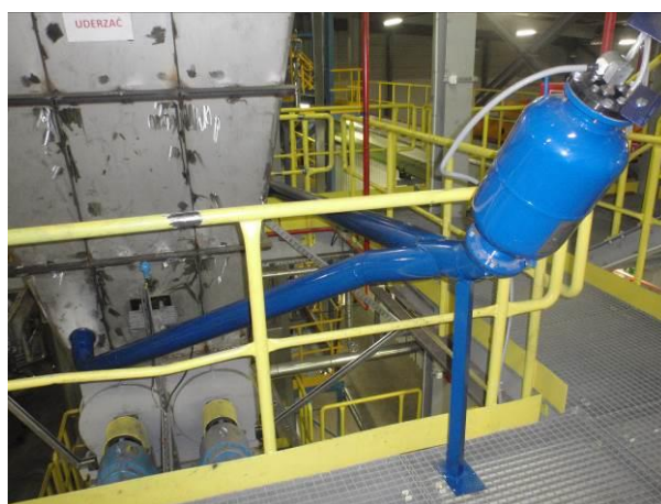
Fot. 11 Zasobnik słomy z zabudowanym generatorem
