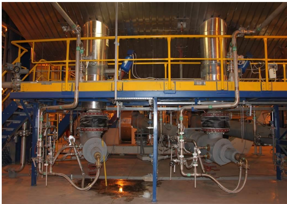
Fot. 1 Instalacja odbioru popiołu kotła fluidalnego w Elektrowni Jaworzno z zabudowanymi generatorami fal uderzeniowych GFU-24/8.
