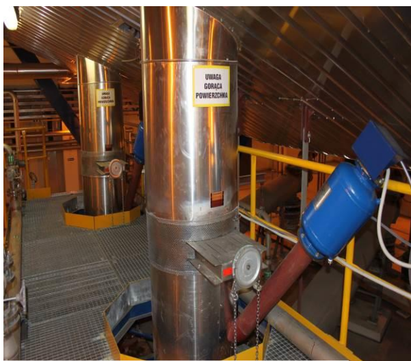
Fot. 16 Rura zsykowa popiołu kotła fluidalnego.
