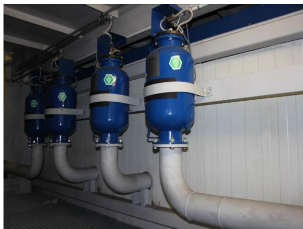
Fot. 14. Generatory fal uderzeniowych zabudowane na absorberze.
