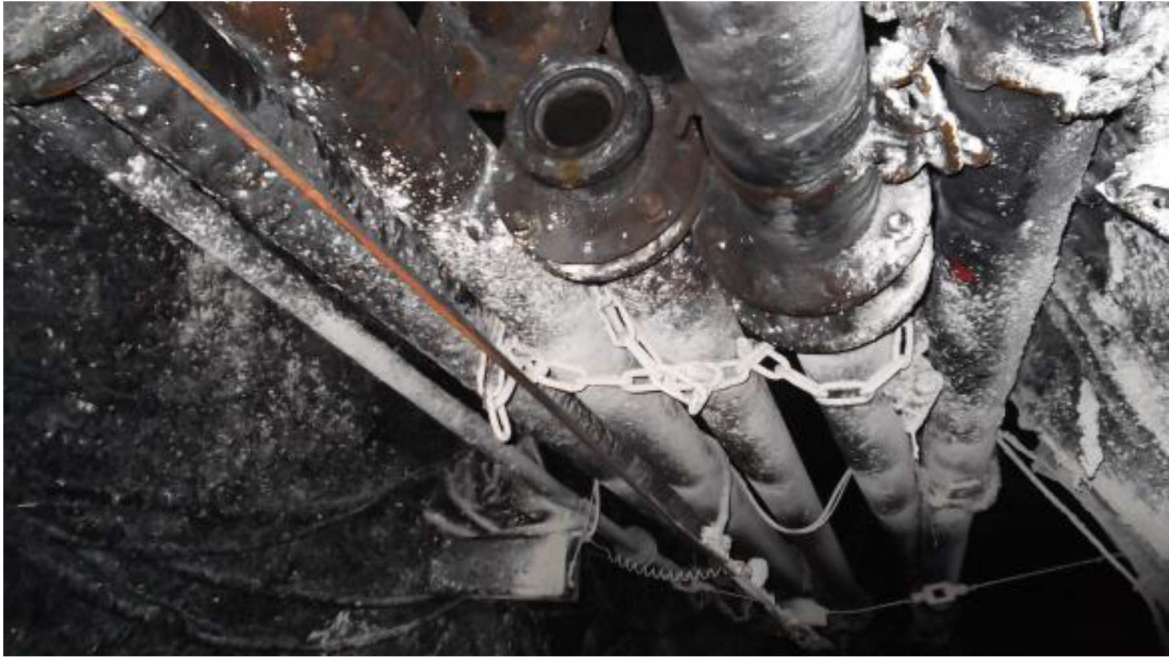
Fot. 2. Rurociągi technologiczne
