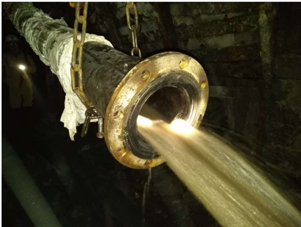
Fot. 5. Struga wody z rurociągu
