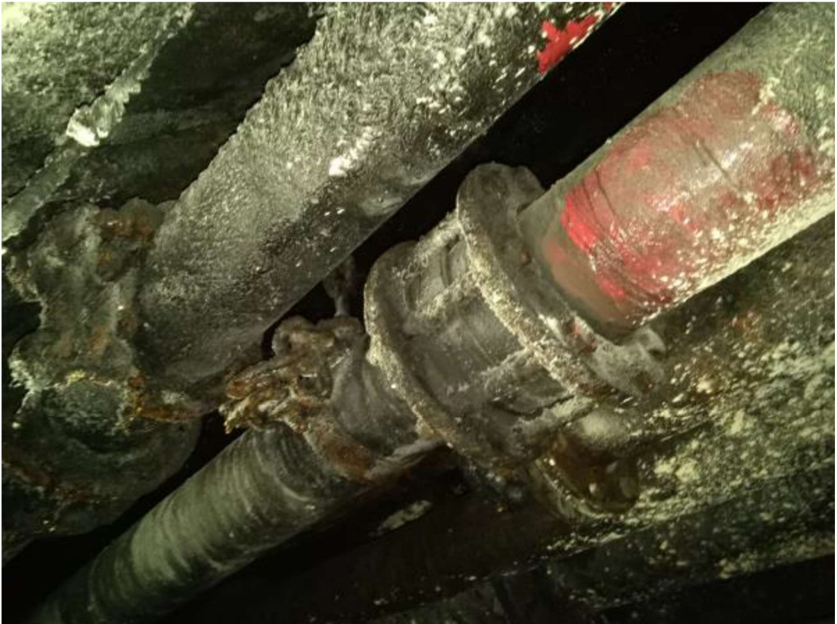
Fot. 2. Rurociągi technologiczne
