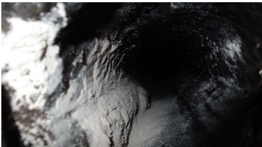
Fot. 3. Zanieczyszczony rurociąg technologiczny
