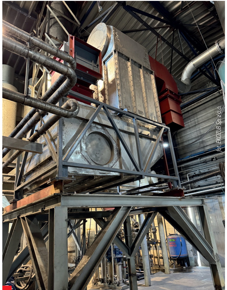
FOT. 2 Mokre odpylanie spalin dla kotła rusztowego o mocy 5 MW
