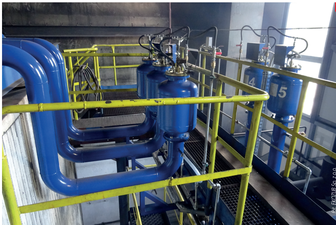
FOT. 3 System czyszczenia pęczków konwekcyjnych kotła WR-10
