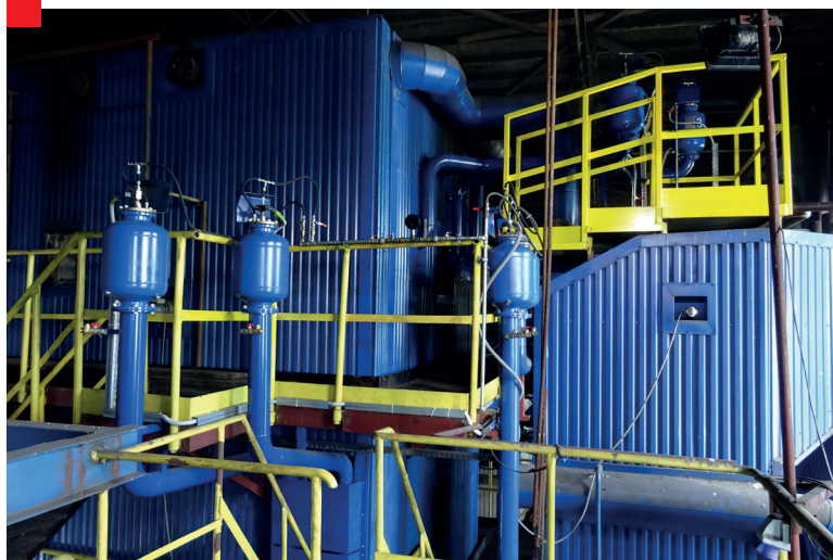
FOT. 1 Instalacja czyszczenia kotła WR-10 oparta o generatory fal uderzeniowych sprężonego powietrza. Źródło: zasoby autora
